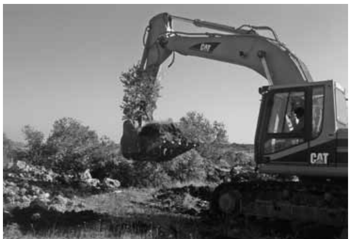
Ende 2004 werden für eine neue israelische Siedlung bei Jayyous über 100 Olivenbäumen entfernt
